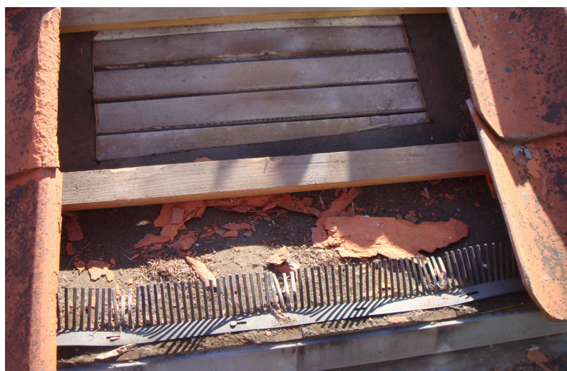
Destruktiv undersøgelse af tag viste store mængder afskalninger af forvitrede sten.
